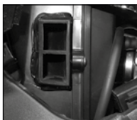
Imagen 18. Filtro de aire.
